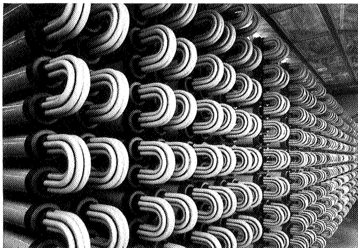
Hyperfiltratie-installatie: sectie 1, buisvormige membranen
